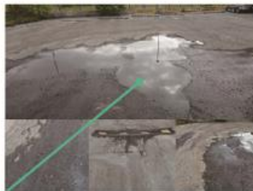
通常のアスファルト (高温、雨水などで舗装が破壊)
